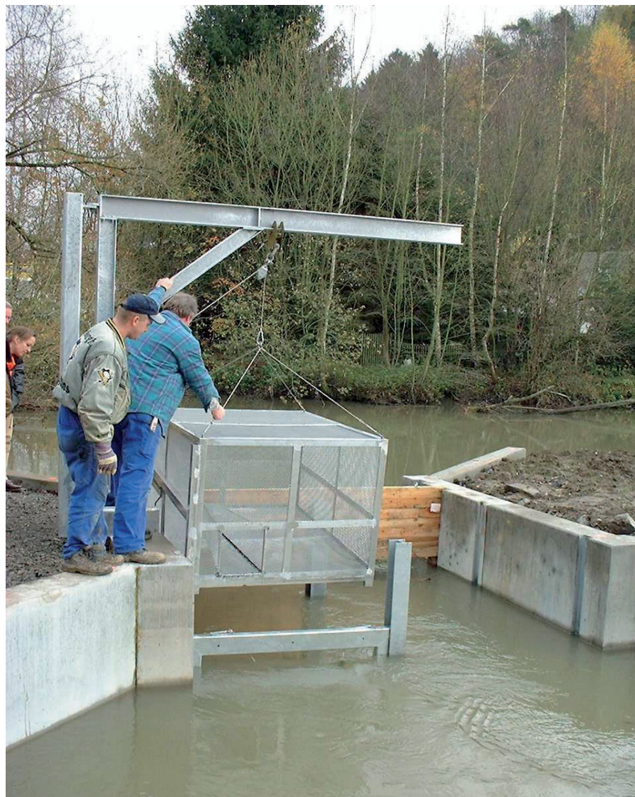
Abb. 4: Einlaufbauwerk.Umgehungsgerinne Hadamar (Elbbach) mit Kontrolleinrichtung (Foto: W. Fricke).
