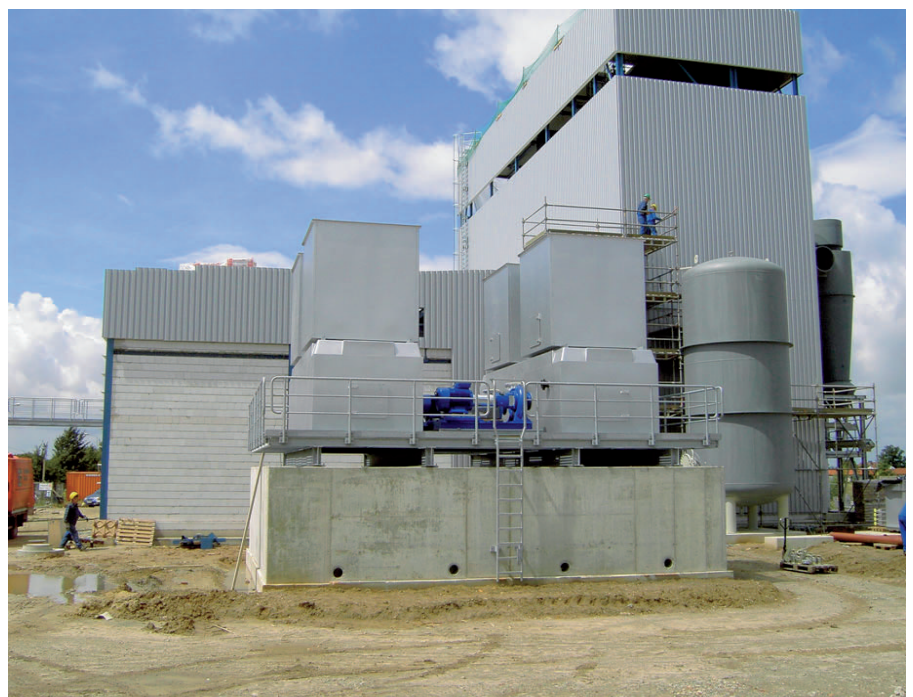
Abb. 5: Das Biomasse-Heizkraftwerk Sellessen (Foto: Vattenfall Europe).
